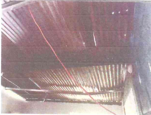
Foto 4: ESTADO ACTUAL DE LA BODEGA , FILTRACIONES DE AGUA POR TECHO CON AGUJEROS.
