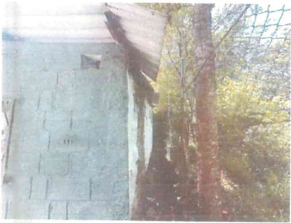
Foto 3: ESTADO ACTUAL DE AULA , TECHO EN MAL ESTADO Y PARED CON FILTRACIONES DE AGUA
