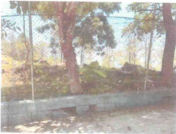
Foto 1: ESTADO ACTUAL DEL MURO PERIMETRAL , MALLA EN MAL ESTADO , SE SUSTITUIRÁ EL MURO DE MALLA POR MURO DE BLOCK
